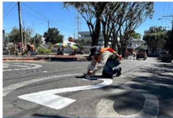
Señalización calle ingreso
