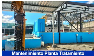
Mantenimiento Planta Tratamiento
