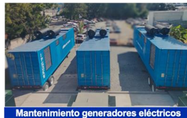
Mantenimiento generadores eléctricos
